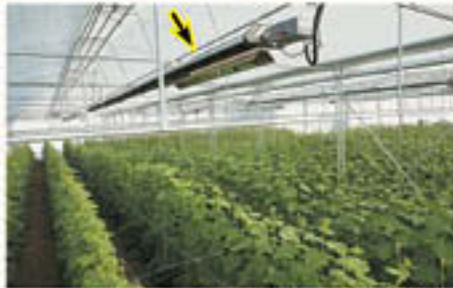
گرمایش گلخانه خانم مرادی - همدان - کشت خیار
